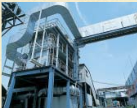
廃熱利用排ガス燃焼装置
